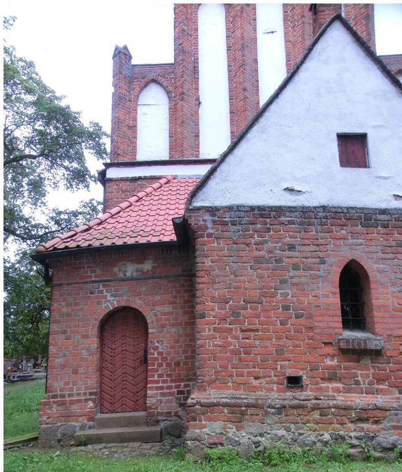
Fot.6. Stan zachowania elewacji od strony wschodniej
