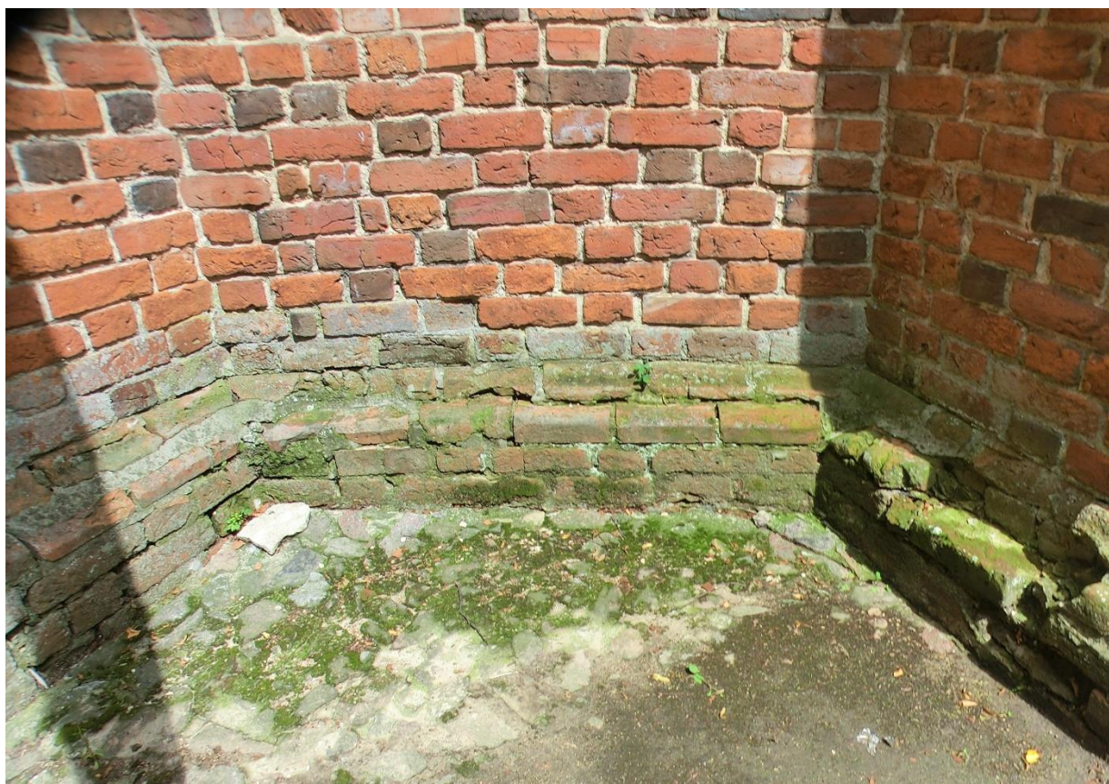
Fot.2. Stan zachowania cokołu wieży
