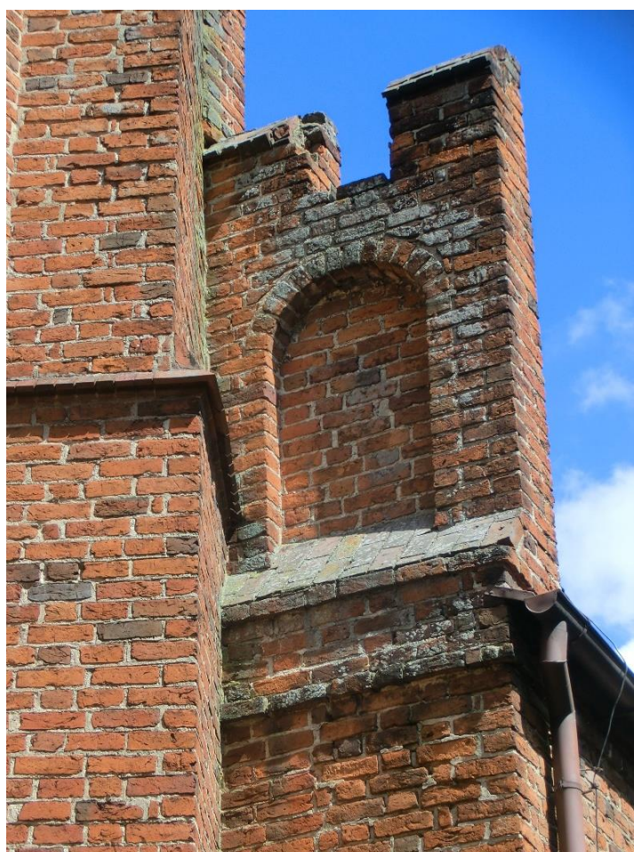
Fot.4. Nawarstwienia porostów oraz ubytki zwieńczenia murów szczytowych
