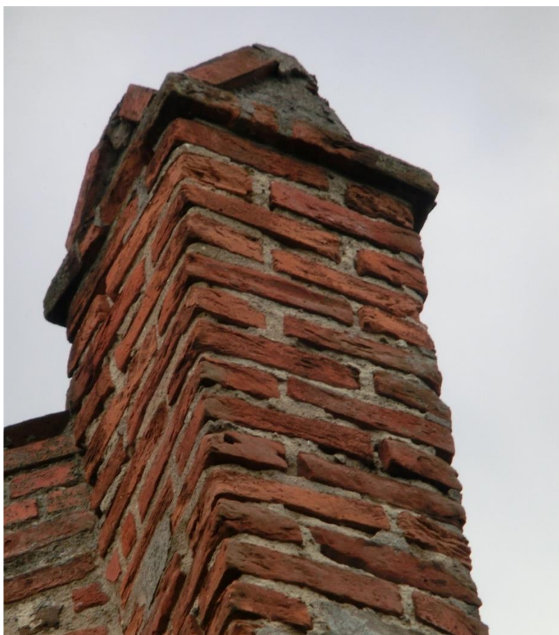
Fot.3. Stan zachowania lic cegieł i spoin na sterczynach
