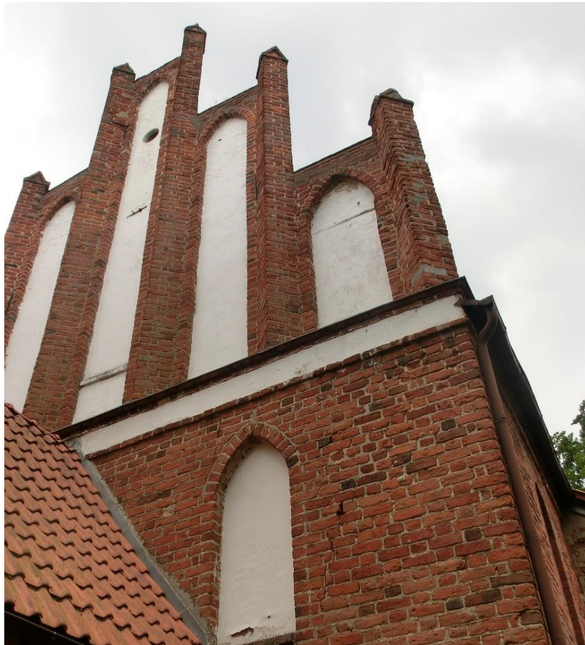
Fot.5. Stan zachowania ściany szczytowej prezbiterium
