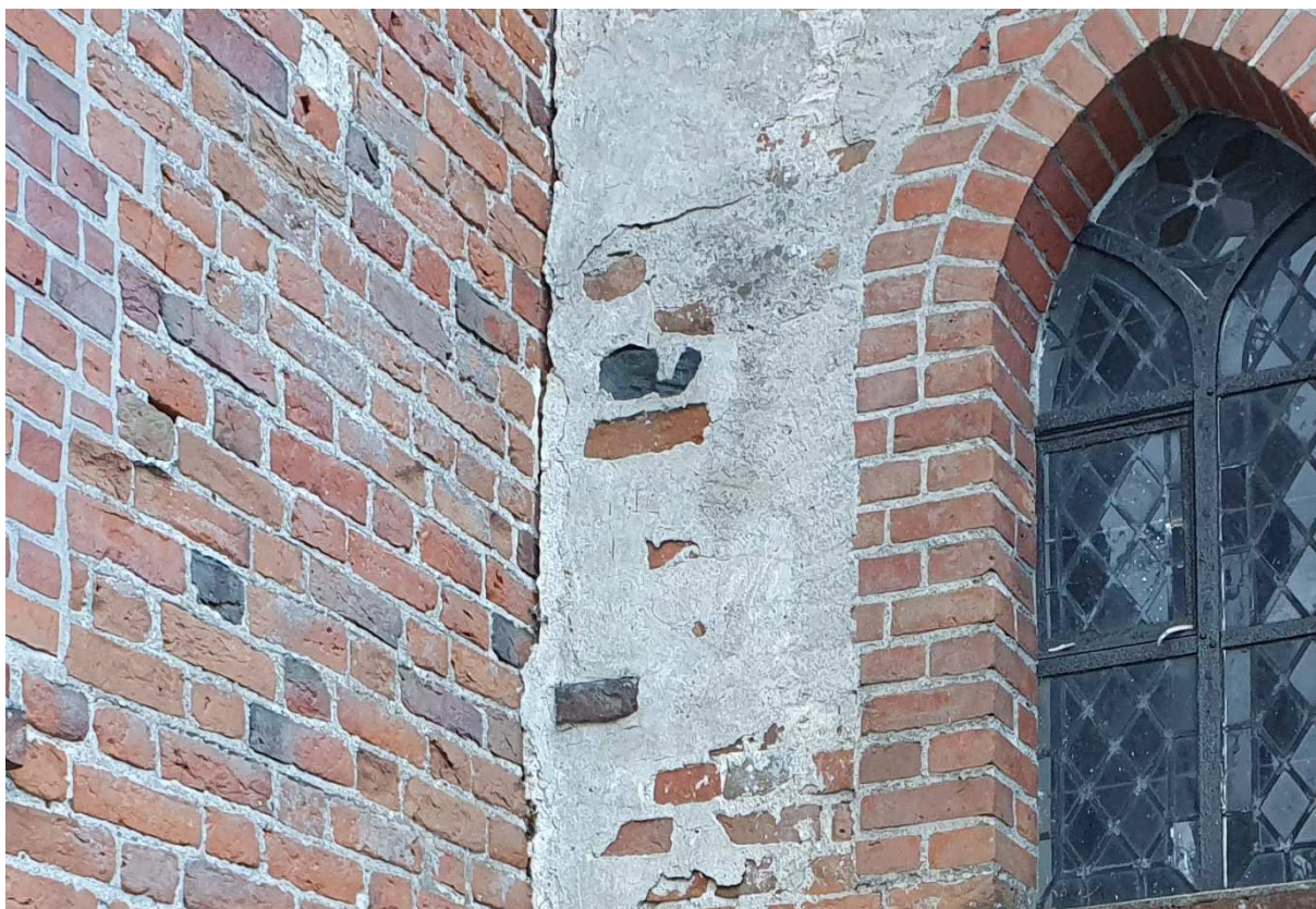
Fot.10. Lembarg, parafia pw. św. Piotra i Pawła. Kaplica przy kruchcie północnej. Pionowe spękanie pomiędzy bryłami budynku podkreślone przez odpajający się tynk.
