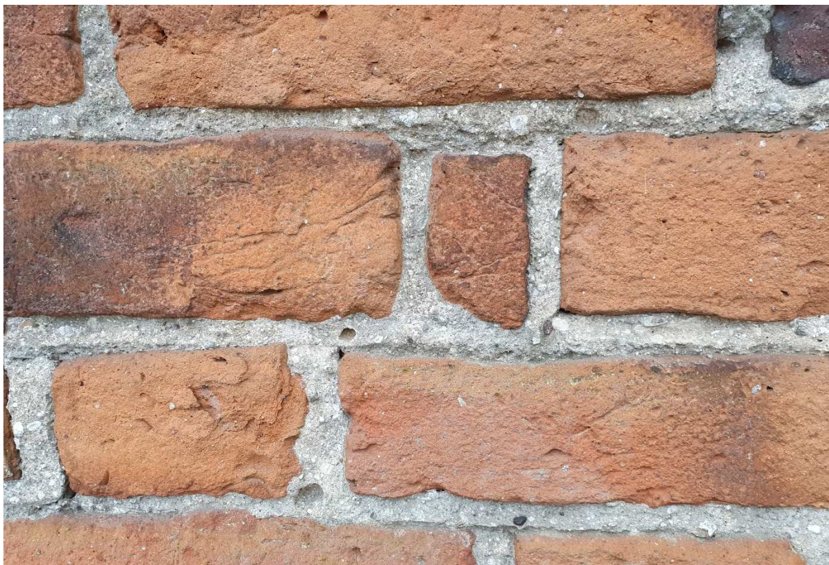
Fot.17. Lembarg, parafia pw. św. Piotra i Pawła. Stan zachowania wątku w obszarach nienarażonych na działanie wody. Na zdjęciu spoina z podcięciem.
