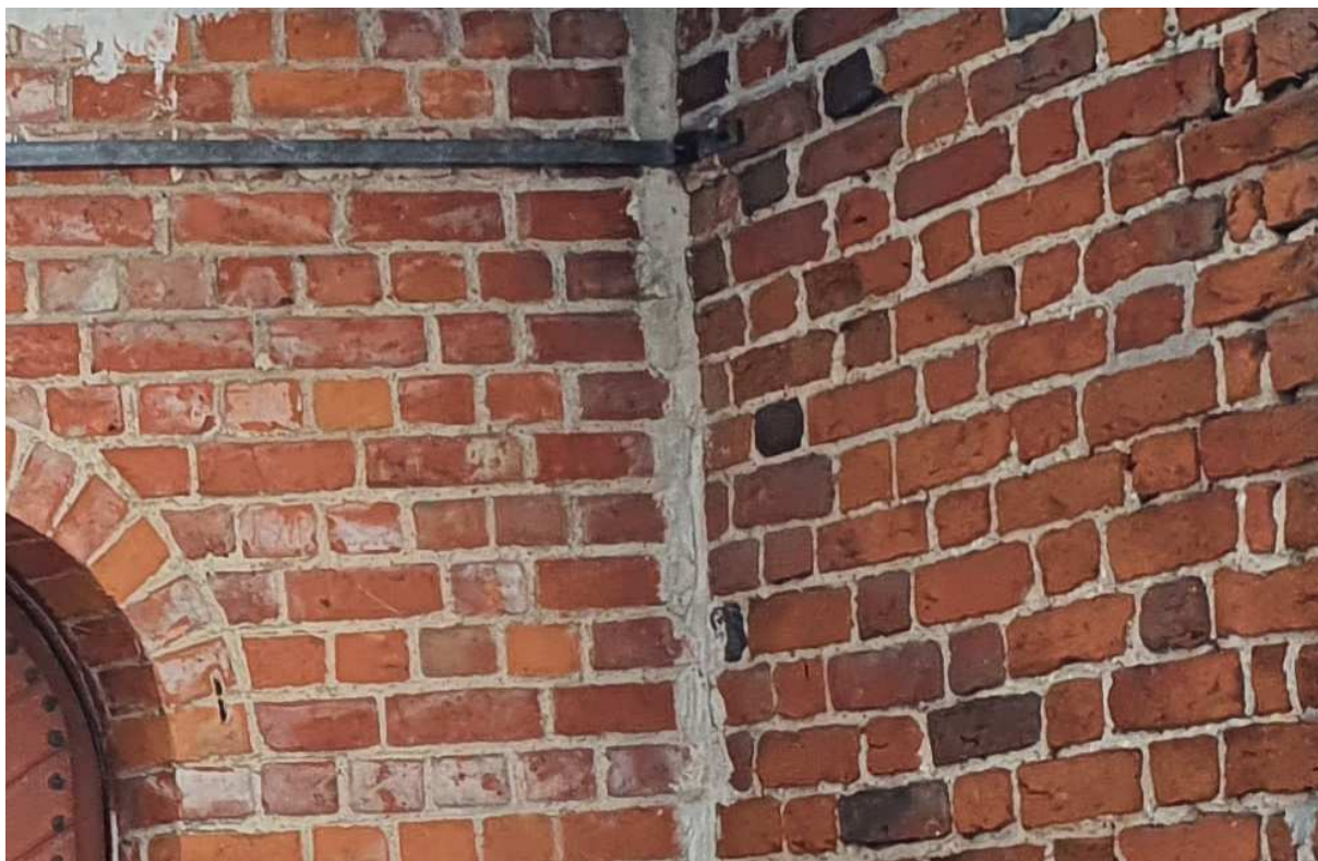
Fot.9. Lembarg, parafia pw. św. Piotra i Pawła. Przybudówka zakrystii. Pęknięcie pomiędzy bryłami architektonicznymi wypełnione zaprawą.
