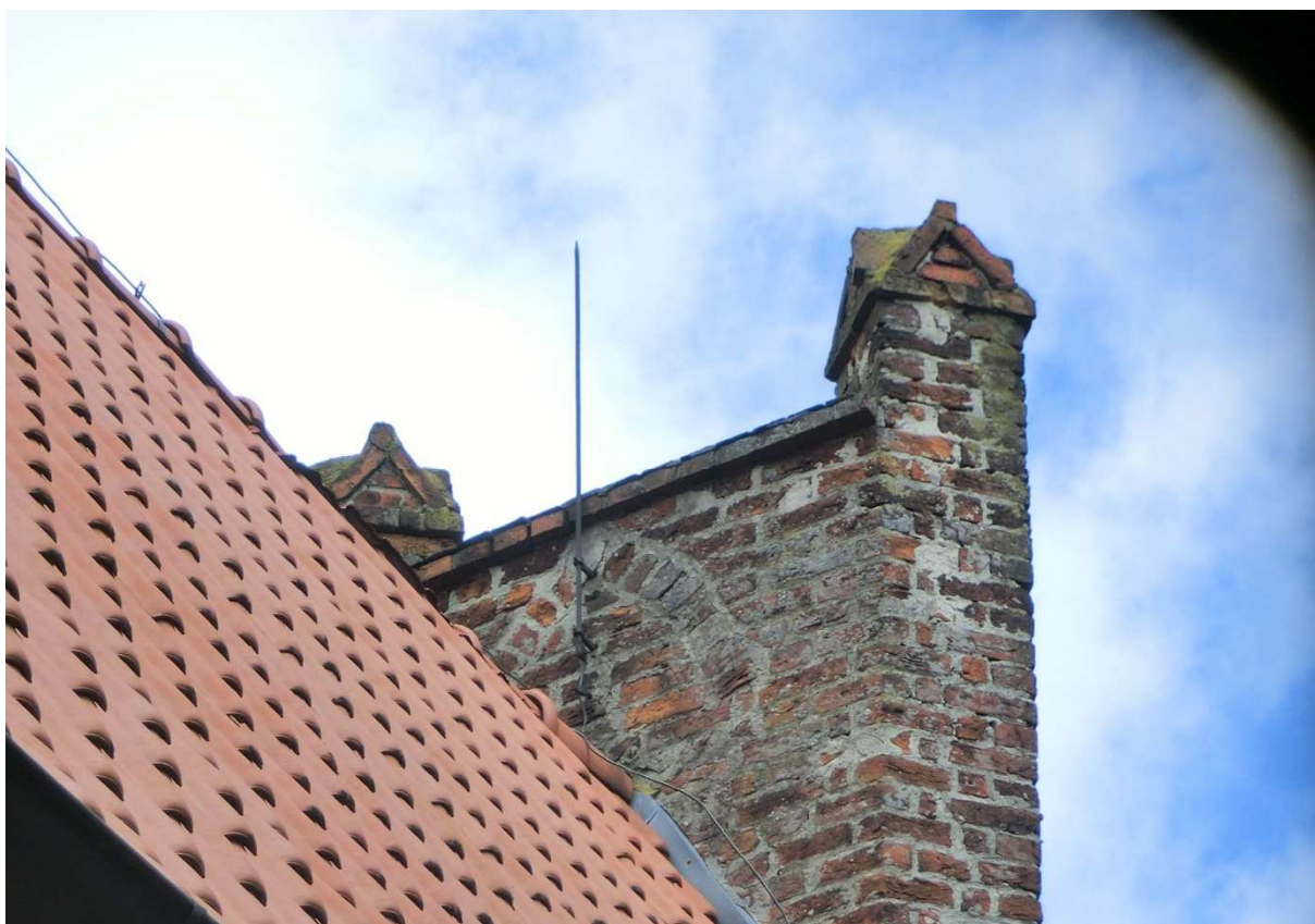
Fot.14. Lembarg, parafia pw. św. Piotra i Pawła. Sterczyny szczytu wschodniego. Ślady prowizorycznych napraw.
