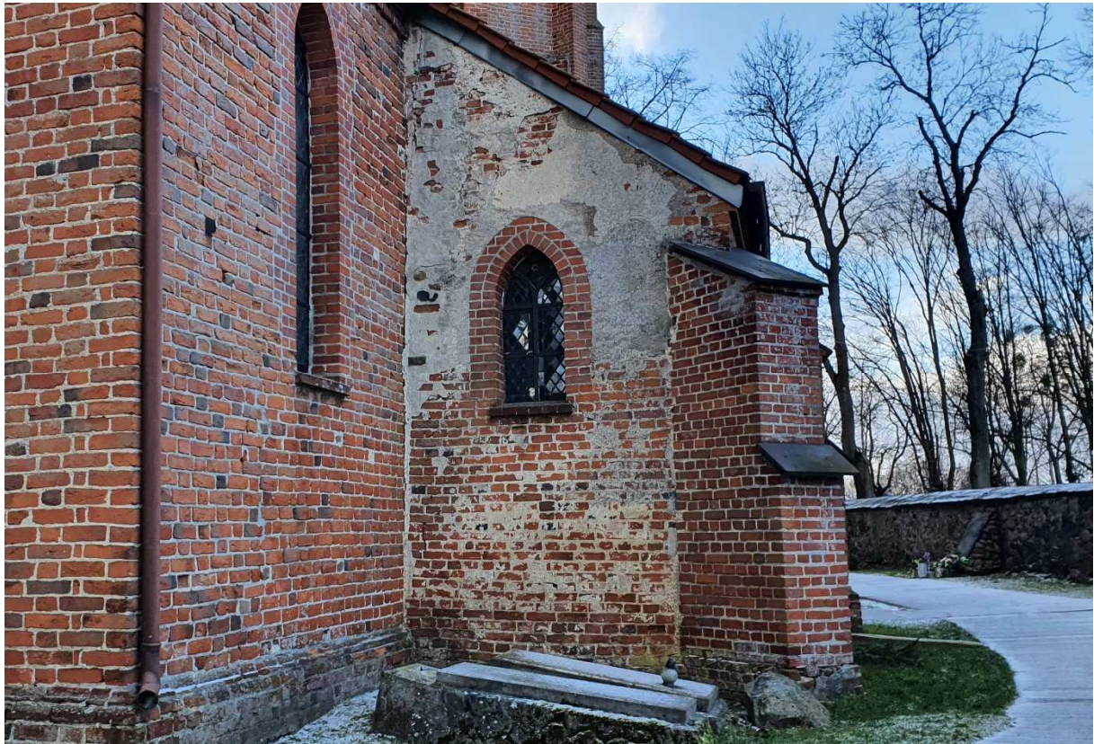
Fot.21. Lembarg, parafia pw. św. Piotra i Pawła. Szczątkowo zachowane tynki na wschodniej ścianie kaplicy.
