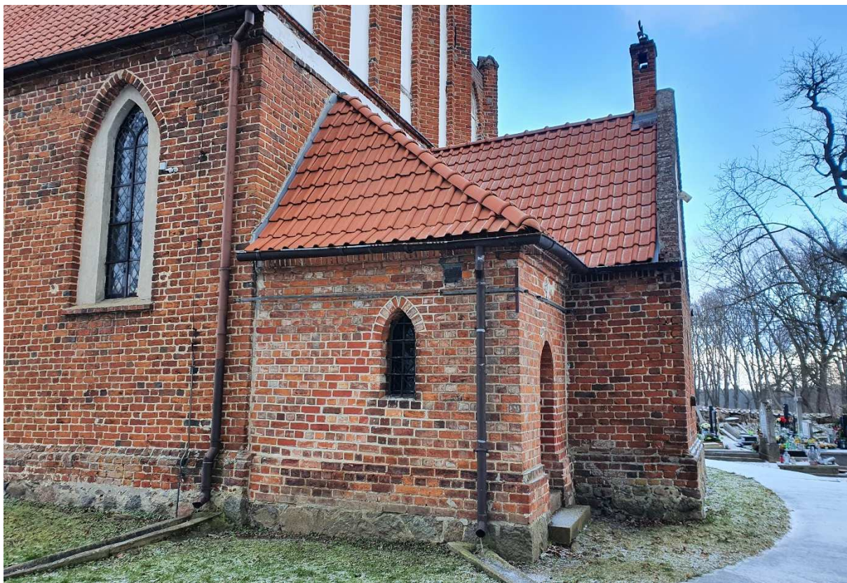
Fot.7. Lembarg, parafia pw. św. Piotra i Pawła. Widok ogólny na zakrystię od strony południowej. Na zdjęciu widoczne także kotwy spinające koronę muru przybudówki.
