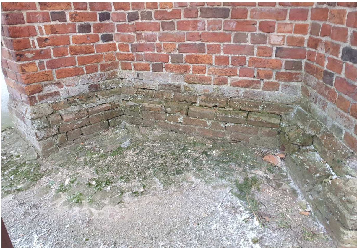
Fot.12. Lembarg, parafia pw. św. Piotra i Pawła. Cokół wieży. Liczne ubytki spoiny.
