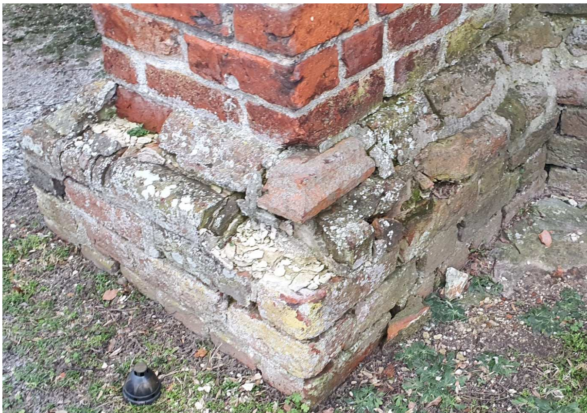
Fot.11. Lembarg, parafia pw. św. Piotra i Pawła. Cokół przypory wieży. Stan zachowania wątku ceglanego. Wątek jest rozluźniony, spoina wykruszona.
