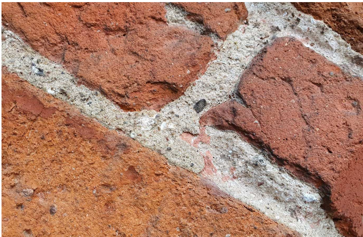
Fot.19. Lembarg, parafia pw. św. Piotra i Pawła. Stan zachowania wątku w obszarach nienarażonych na działanie wody. Portal kruchty północnej. Spoina z zachowaną czerwoną monochromią.
