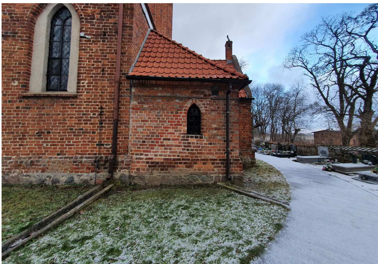
Fot.24. Lembarg, parafia pw. św. Piotra i Pawła. Aktualny, powierzchniowy sposób odprowadzenia wody opadowej.
