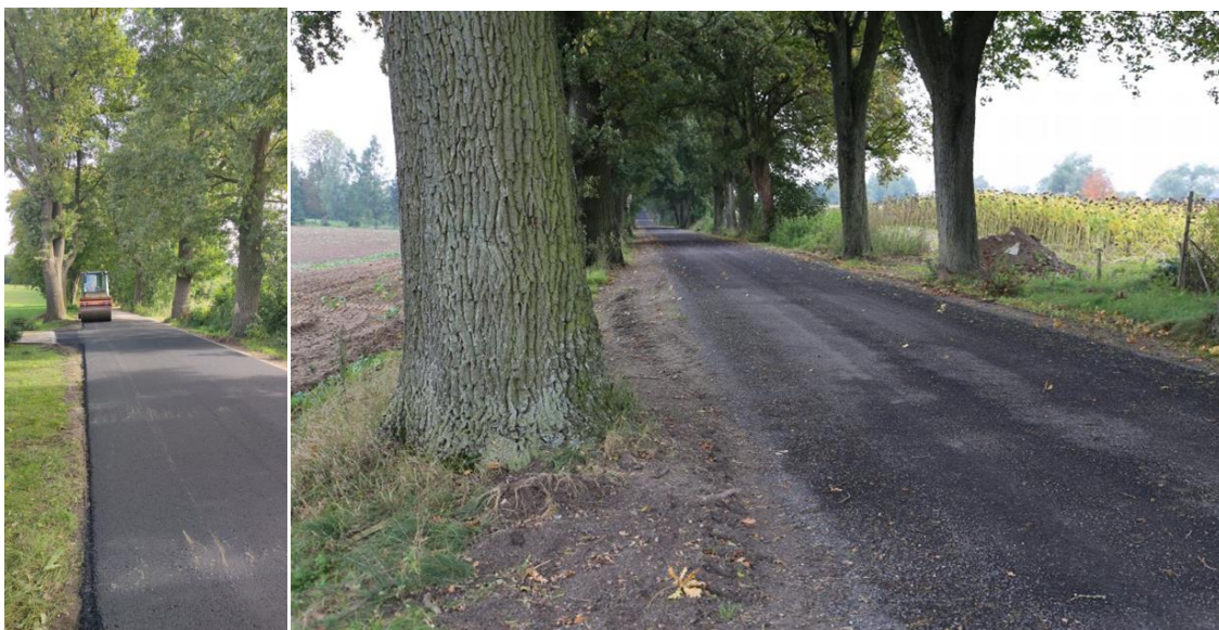
Fot. 4.8.12. i 4.8.13. Wykonywanie powierzchniowego utrwalenia emulsją asfaltową i grysem kamiennym drogi gminnej nr 080102C w miejscowości Konojady. (źródło: UMiG Jabłonowo Pomorskie)
