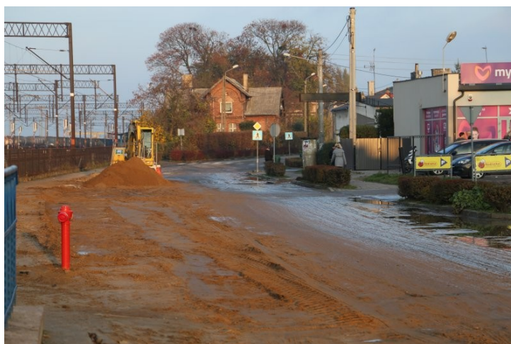
Fot. 4.1. Remont drogi powiatowej – ul. Kolejowa. Samorząd Miasta i Gminy Jabłonowo Pomorskie współfinansuje inwestycję. (źródło: UMiG Jabłonowo Pomorskie - Listopad 2019)
