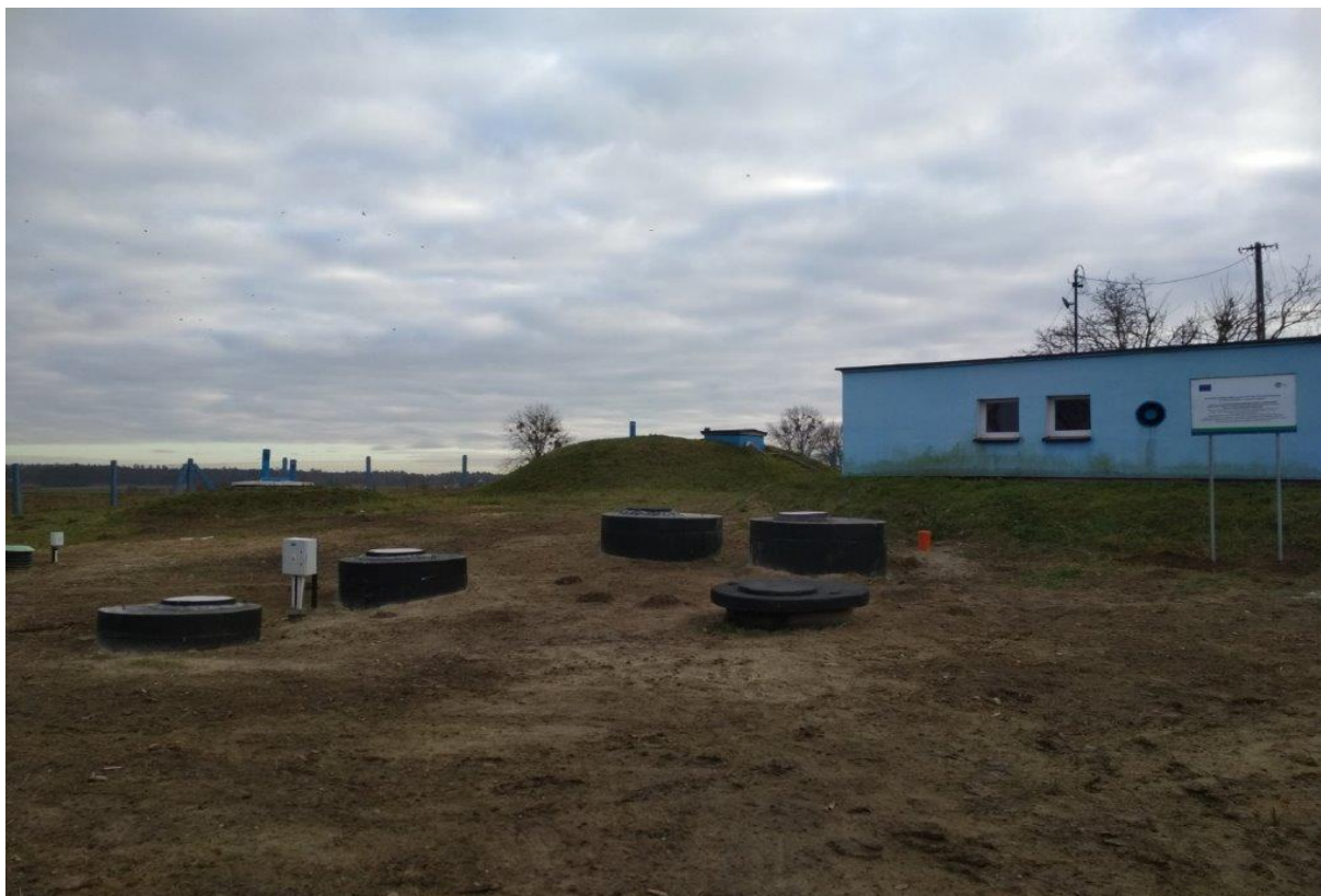
Fot. 4.21. Przebudowa stacji uzdatniania wody w miejscowości Górale (źródło: UMiG Jabłonowo Pomorskie)
