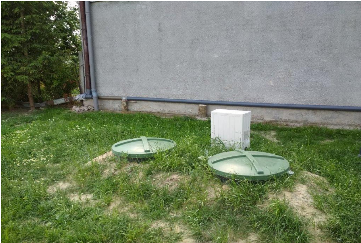
Fot. 4.9. Budowa przydomowych oczyszczalni ścieków na terenie Miasta i Gminy Jabłonowo Pomorskie (źródło: UMiG Jabłonowo Pomorskie)
