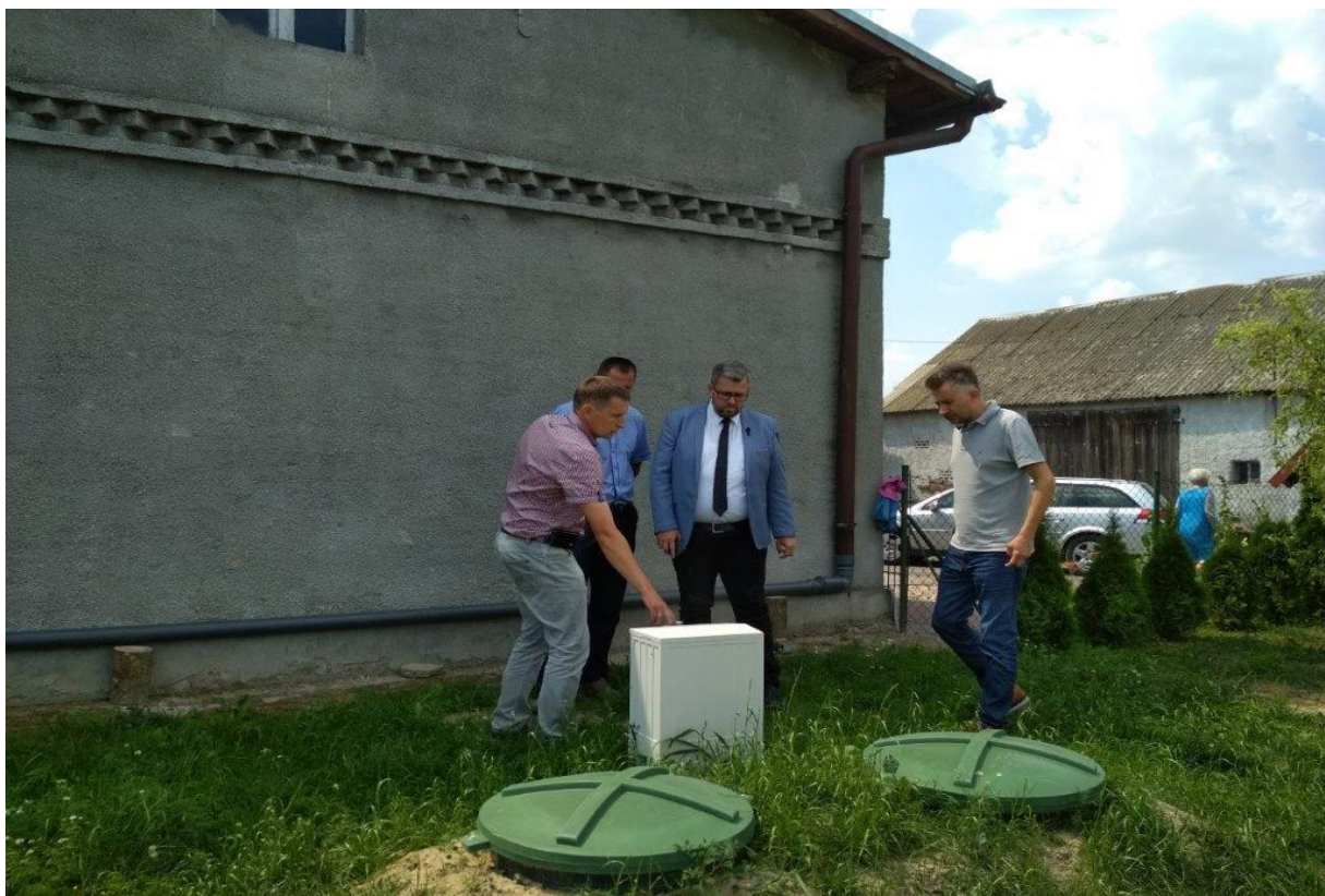
Fot. 4.8. Budowa przydomowych oczyszczalni ścieków na terenie Miasta i Gminy Jabłonowo Pomorskie (źródło: UMIG Jabłonowo Pomorskie)
